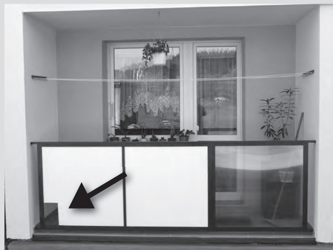
I takto se dovedou nájemníci chovat ke svým nově opraveným bytům. Na snímku vidíte vlevo dole do nové balkonové výplně vyřezanou díru pro čtyřnohého mazlíčka
