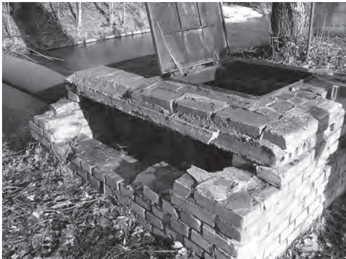
Šachta na vodovodním potrubí u Ratkovské lávky, ze které někdo odebral část cihelné zdi.
