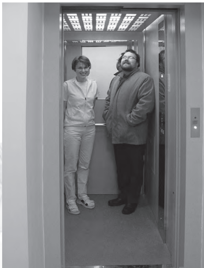
Nový výtah ve zdravotním středisku jako první vyzkoušeli MUDr. Jindřiška Pavlínová se starostou města.
