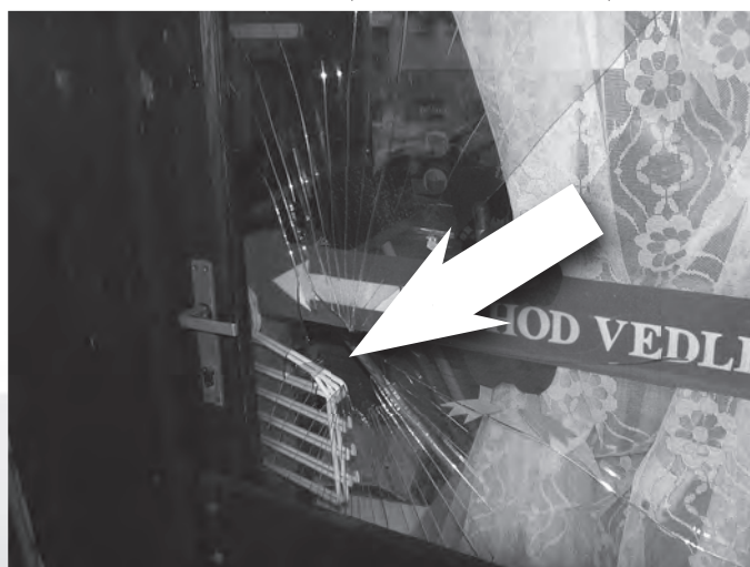
Rozbitá skleněná výplň ve dveřích provozovny v Domě služeb.
