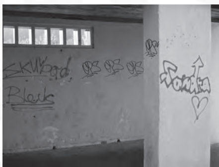
Konečně se ve městě objevili také sprejeři a začali svou činnost na stanovnické vlakové zastávce
