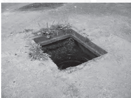
To není díra do země ve dvoře mateřské školy, ale rám kanalizační silniční mříže, kterou někdo prachspolečně ukradl
